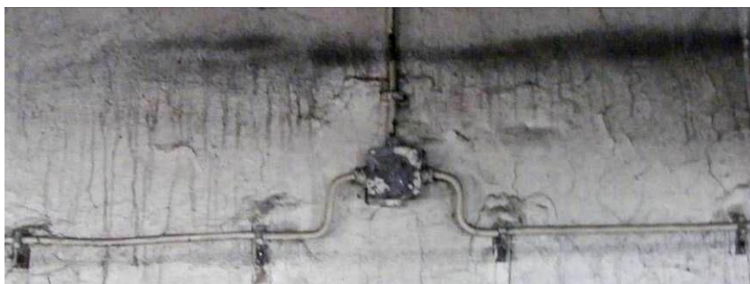
obr. 232 – kabelový rozvod na povrchu
