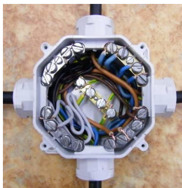
obr. 208 – ukončení kabelů v krabici
