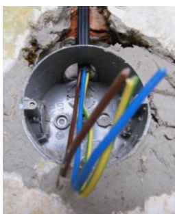
obr. 218 – ukončení vrchní izolace plochého vodiče v krabici
