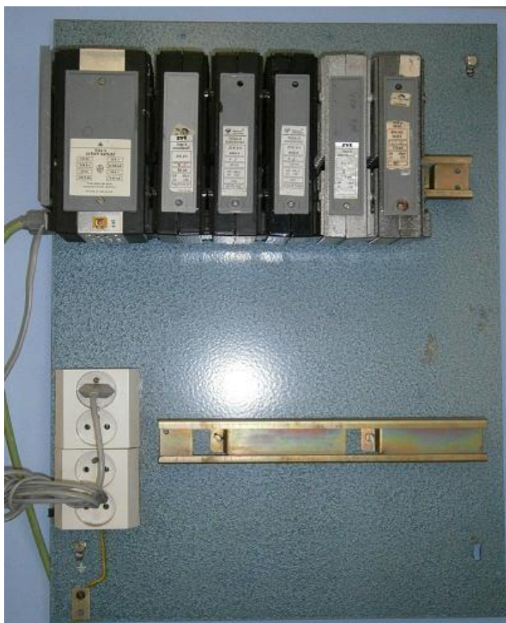
Hlavní stanice systému TESA-S
